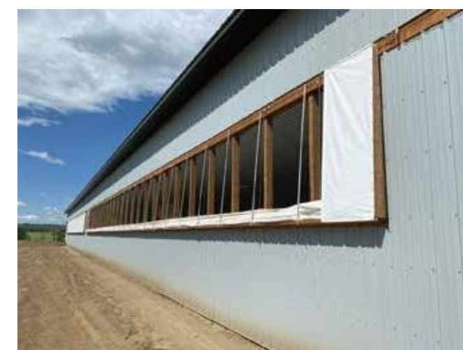
Система зашторивания (складывание штор)
